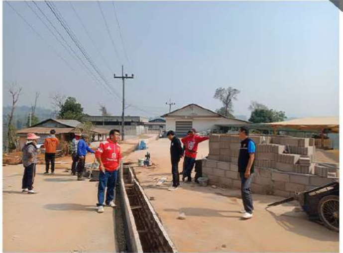
โครงการก่อสร้างรางระบายน้ำ ม.11 บ้านพญาไพรสิทธิ์
