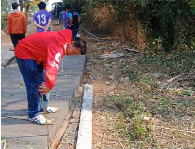
โครงการก่อสร้างถนน คสล. ม.5 บ้านพญาไพรเล่ามา
